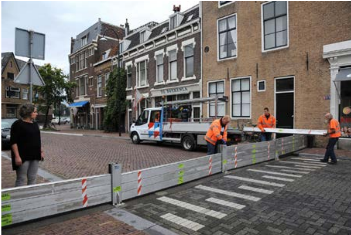
Figure 24. Flood barrier extensions on the Voorstraat. FROM: het financiele dagblad.
